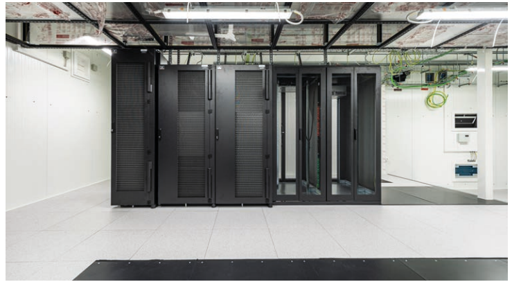
Dentro do módulo pré-fabricado da Vertiv
